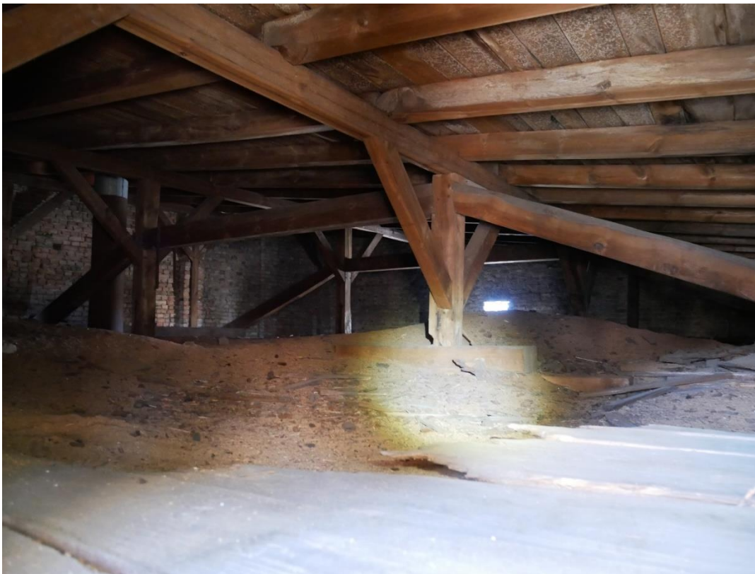
Abb.7 Eine der Habitatstrukturen von Fledermäusen in den Zapflöchern der Dachkonstruktion (Foto G. Pelz)
