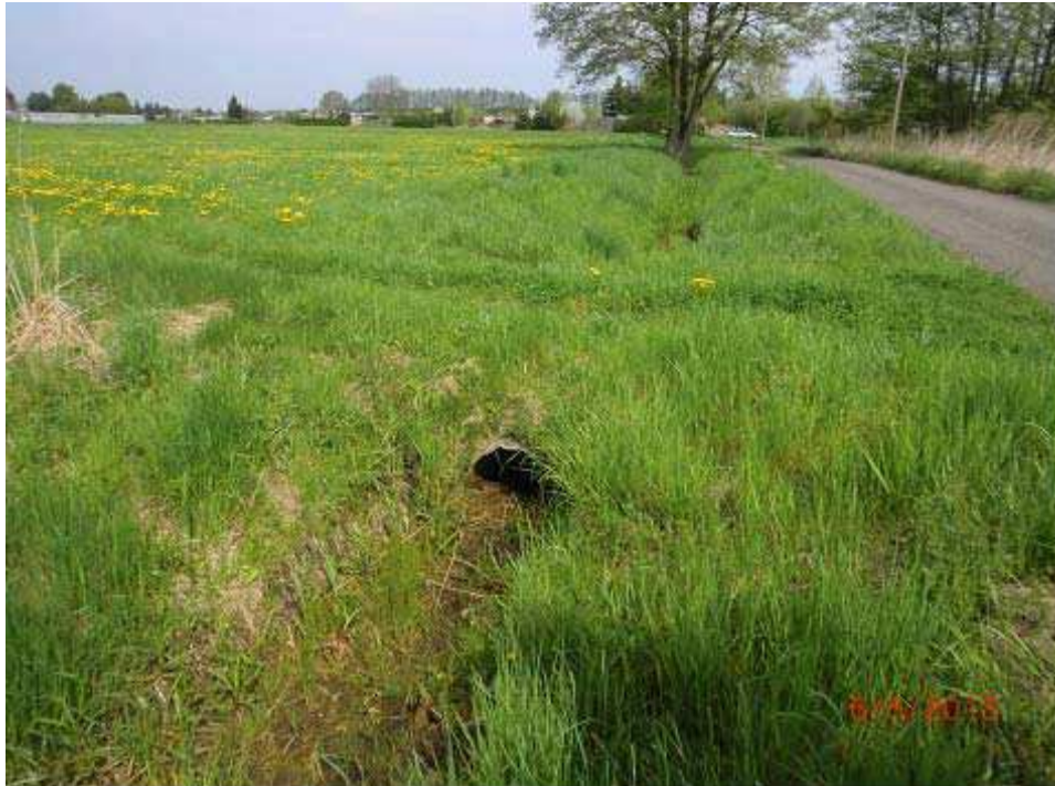
Bild 3: vorhandener Mittelbuschgraben mit (zu hohem) Durchlass
