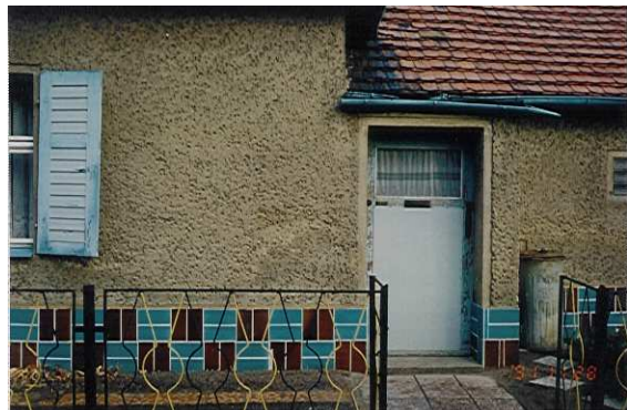
Spaltplattenverkleidungen verunschönen und „verdecken“ nur vorhandene Bauschäden
