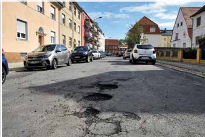
Vor der Sanierung hatte die Brahmbuschstraße einige große Schlaglöcher.
