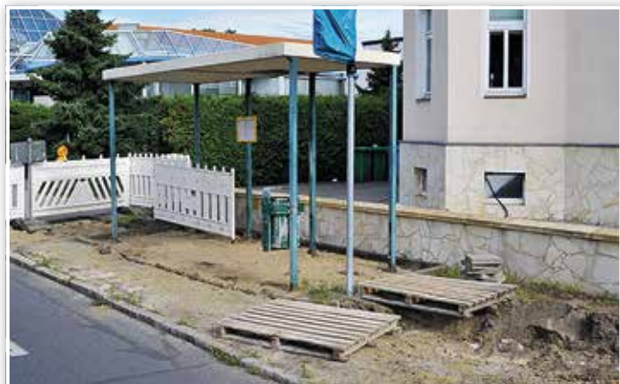
Bauarbeiten an der Bushaltestelle in der Brandenburger Straße, noch mit niedrigem Bord.
