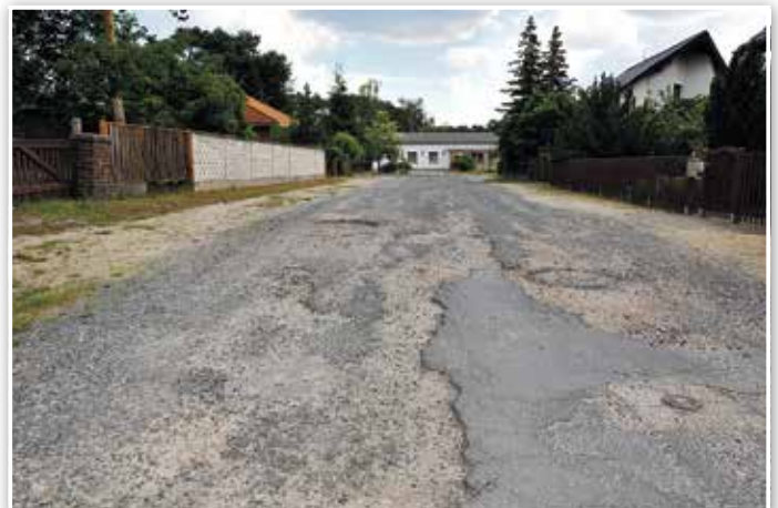
Der Buchenweg in der Bergsiedlung braucht eine neue Asphaltdeckschicht.
