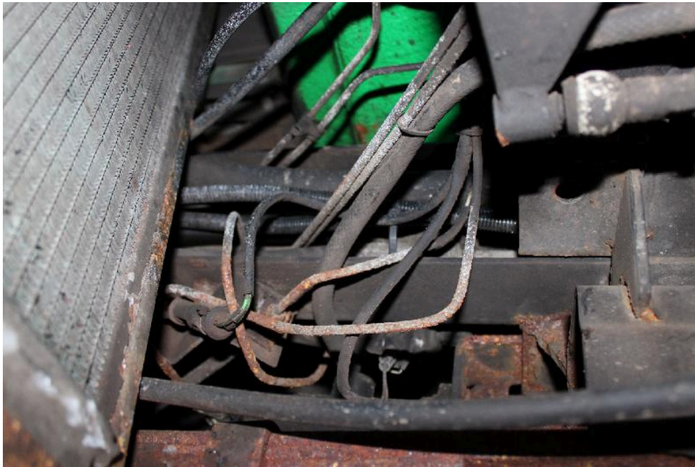
Bild: 25 Bremsleitungen, rostig
