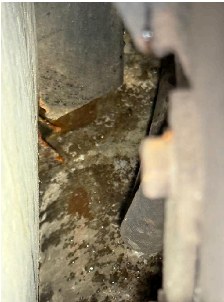
Bild: 32 Hilfsrahmen des Hydraulikbehälters gerissen
